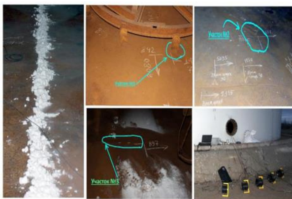
Рис. 6. Обнаруженные источники АЭ при локальном низкотемпературном нагружении днища резервуара.
